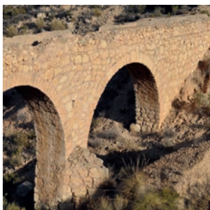
Acueductos del Canal
